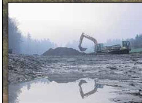
Der Gfillmoosweiher ist ausgehoben und parat für die Karpfen, welche im Herbst eingesetzt werden. In rund zwei Jahren wird erstmals abgefischt.
